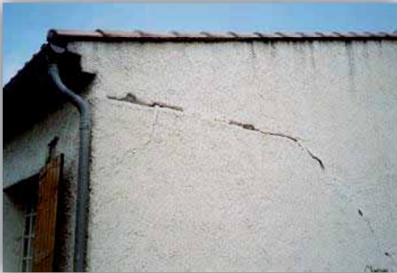
Figure 83 : Illustration de sinistre sur un pavillon, généré par le retrait-gonflement des argiles - argiles.fr
